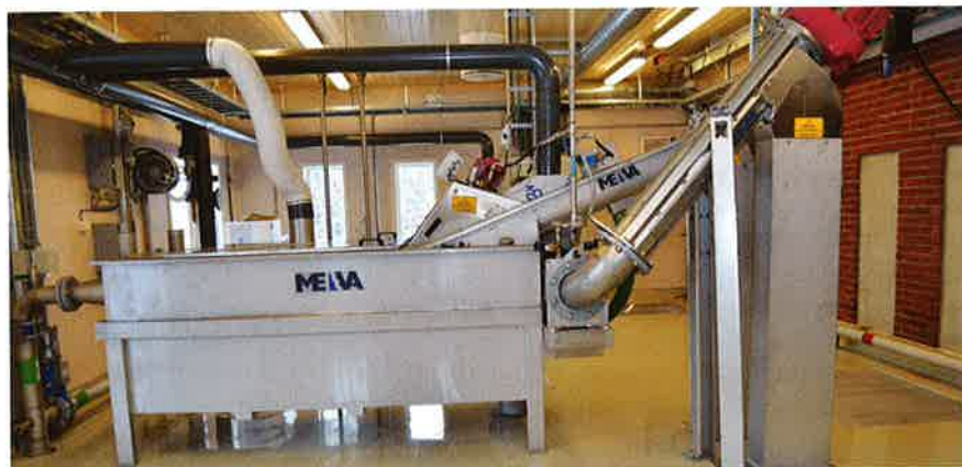
Vellykket: Røros renselanlegg er bygget om med selvbetjening for levering av septik og eksternt slam. Innvendig fremstår anlegget som moderne og effektivt.
